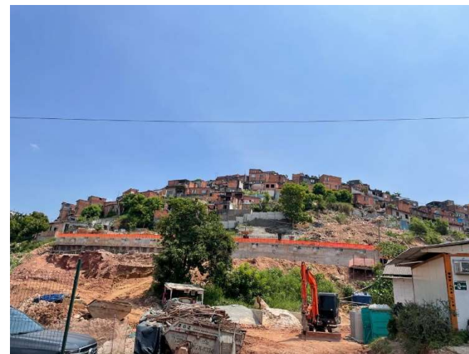
Alto da Alegria. Contenção. Março/2024.
