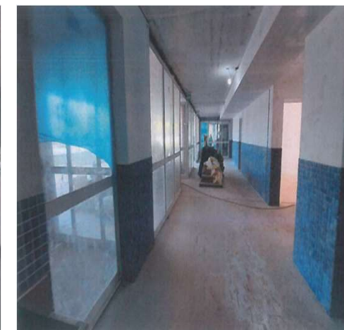
Caxilhos e Pastilha Cerâmica da Creche – Foto: mar./24.
