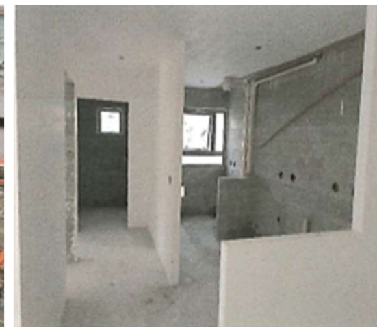
Revestimento de Gesso – Domênico Martinelli Foto: fev./23
