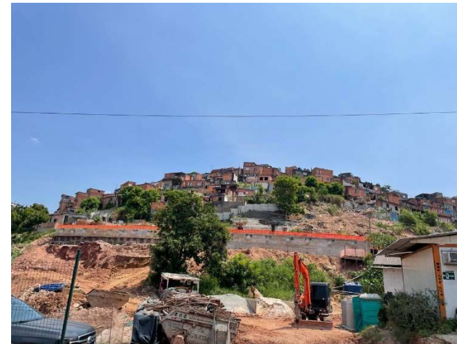
Alto da Alegria. Contenção. Março/2024.
